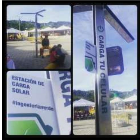
Fig. 1. Diseño e Implementación de un sistema de carga solar.
