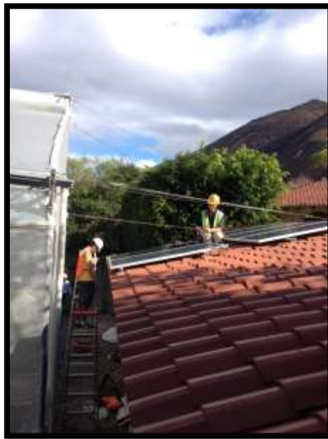
Fig. 2 Implementación de un sistema solar.
